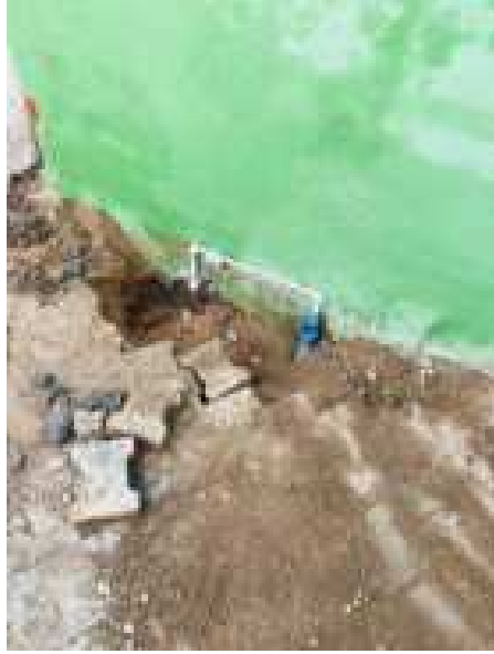
Yeşilova Mahallesi / WC bağlantı
